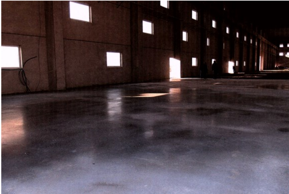
Slika 9 Kvarcni pod u proizvodnoj hali
