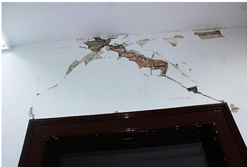
Slika 5.13 Prostorija 15. Oštećenje nadvoja
