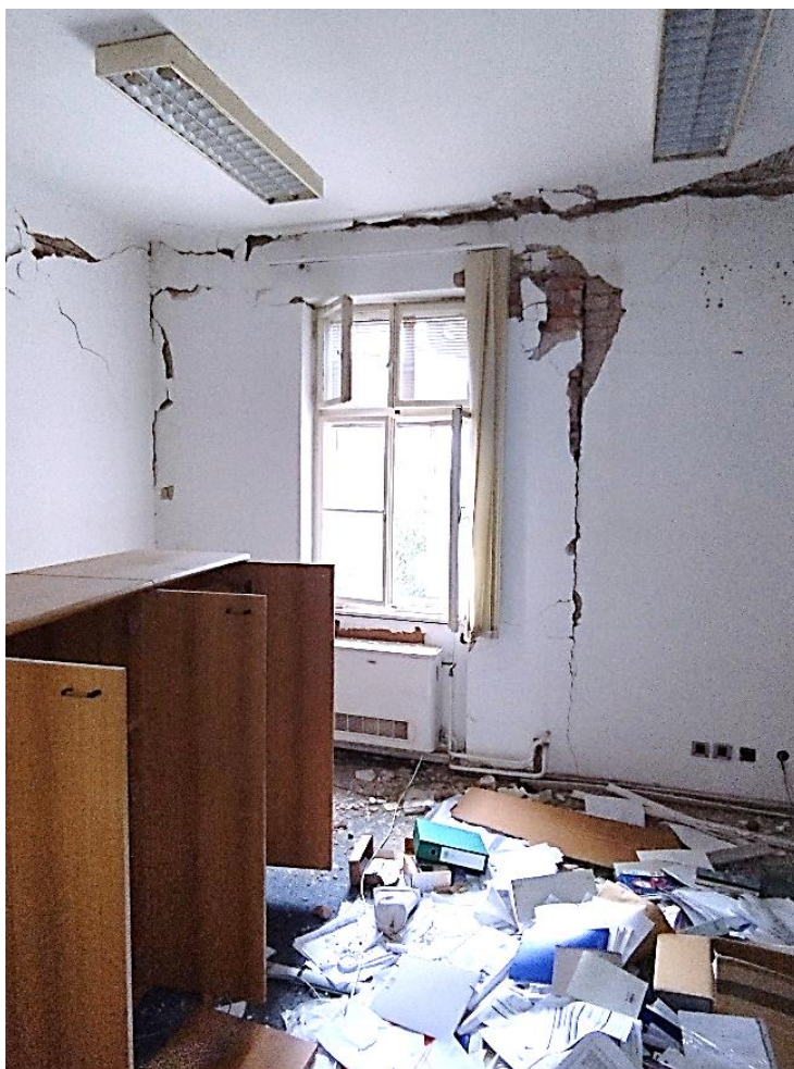
Slika 5.20 Prostorija 16. pukotina na mjestu spojeva 2 zida i međukatne konstrukcije
