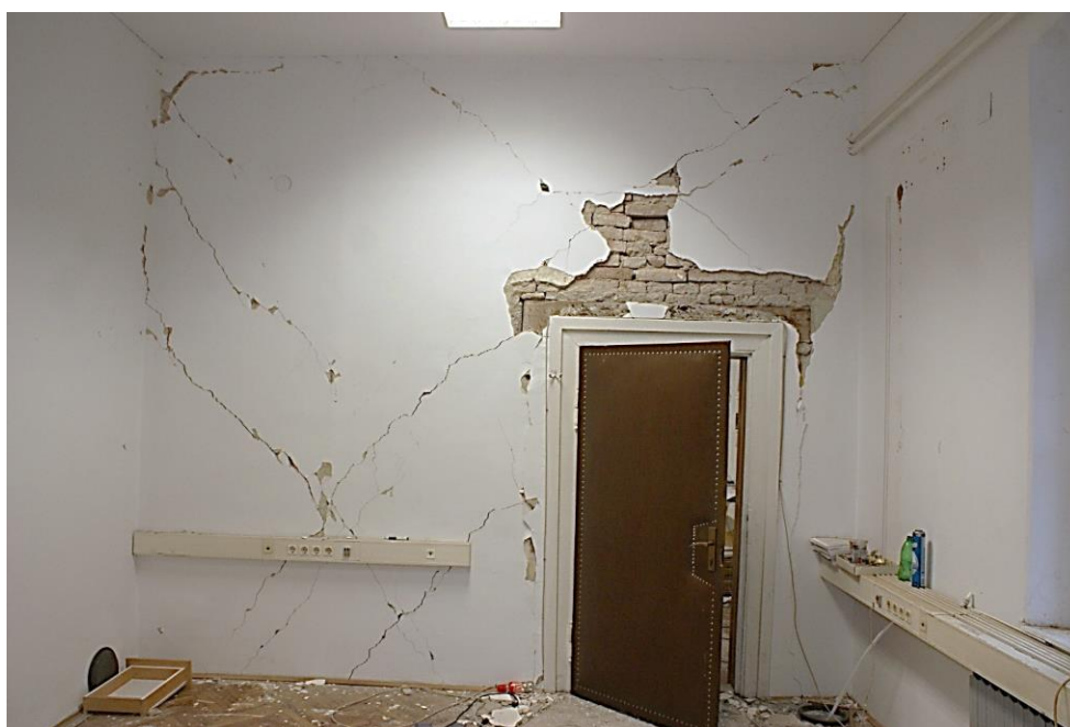
Slika 5.14 Prostorija 25. Rasprostranjene dijagonalne pukotine zida
