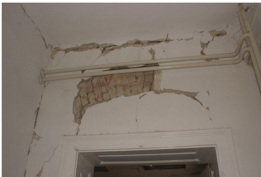
Slika 5.9 Prostorija 1. Pukotine na nadvoja
