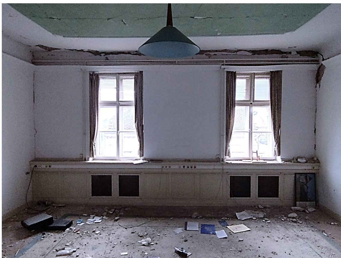
Slika 5.19 Prostorija 7 Pukotina na mjestu spojeva 2 zida i međukatne konstrukcije
