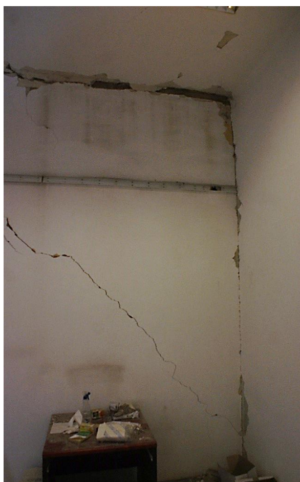
Slika 5.10 Prostorija 2. Dijagonalna pukotina zida
