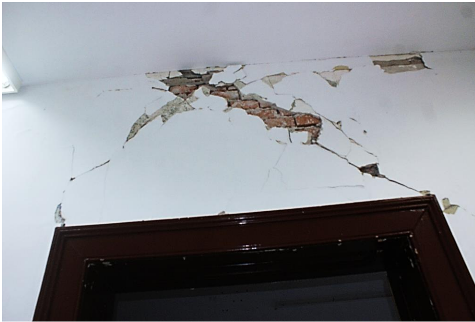
Slika 5.13 Prostorija 15. Oštećenje nadvoja
