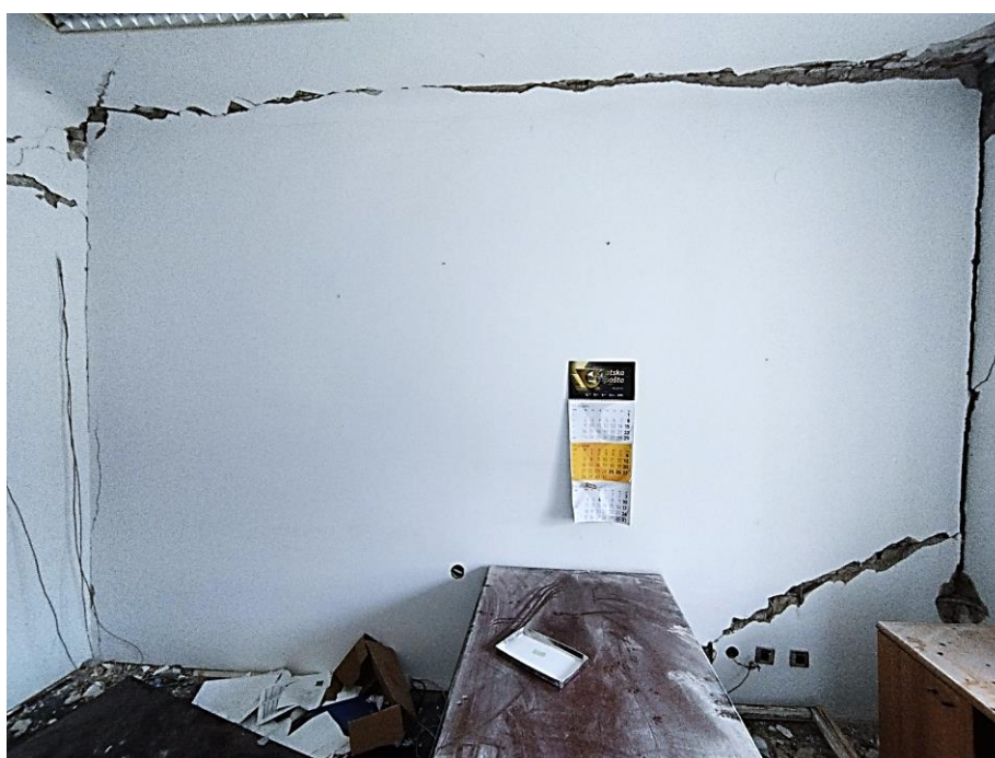
Slika 5.21 Prostorija 17. Pukotina na mjestu spojeva 2 zida i međukatne konstrukcije
