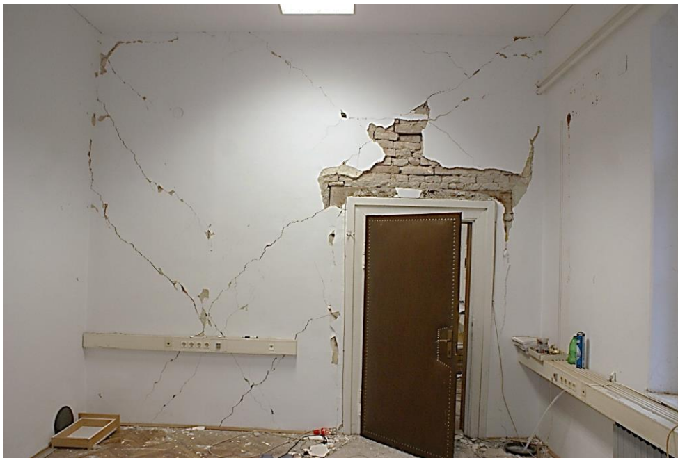
Slika 5.14 Prostorija 25. Rasprostranjene dijagonalne pukotine zida
