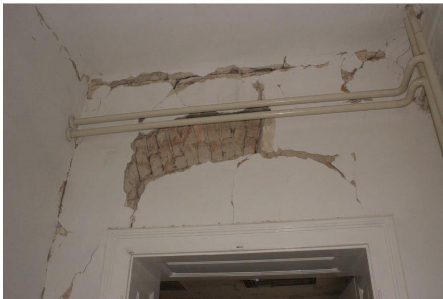
Slika 5.9 Prostorija 1. Pukotine na nadvoja
