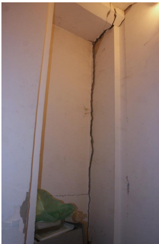
Slika 5.7 Prostorija 24. Pukotina na spoju dva nosiva zida
