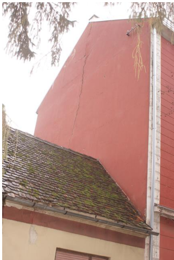
Slika 5.22 Dugačka dijagonalna pukotina
