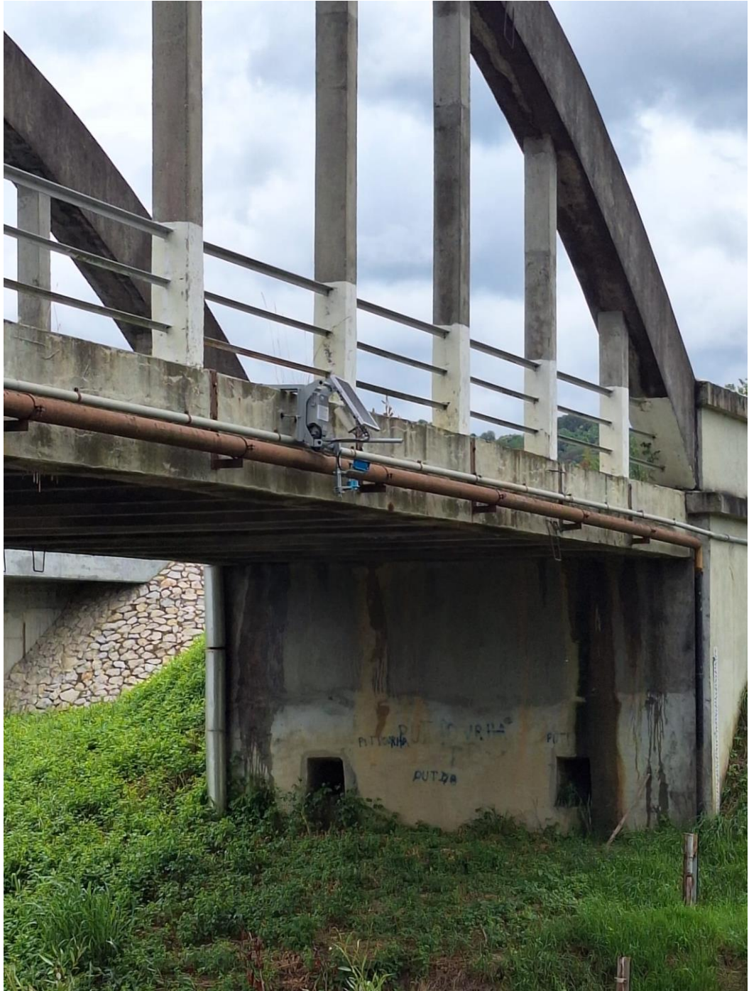
Slika 4.5. Hidrološka postaja Tuhovec [5]
