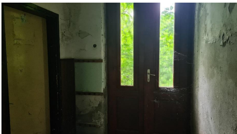
Slika 21. Prikaz oštećenja zidova i dotrajale stolarije
