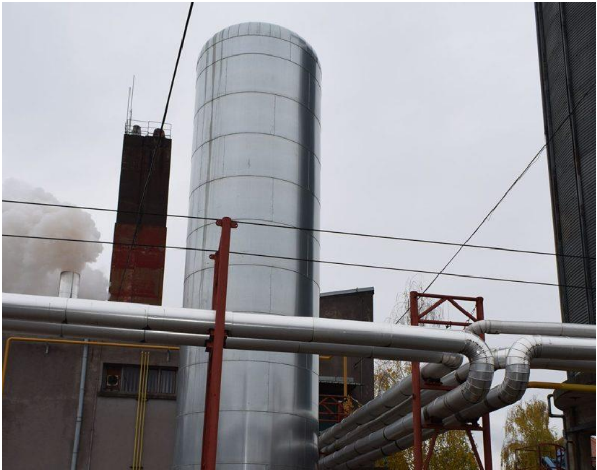
Slika 1 - Akumulacijski spremnik 70 m 3 u Lepoglavi [2]
