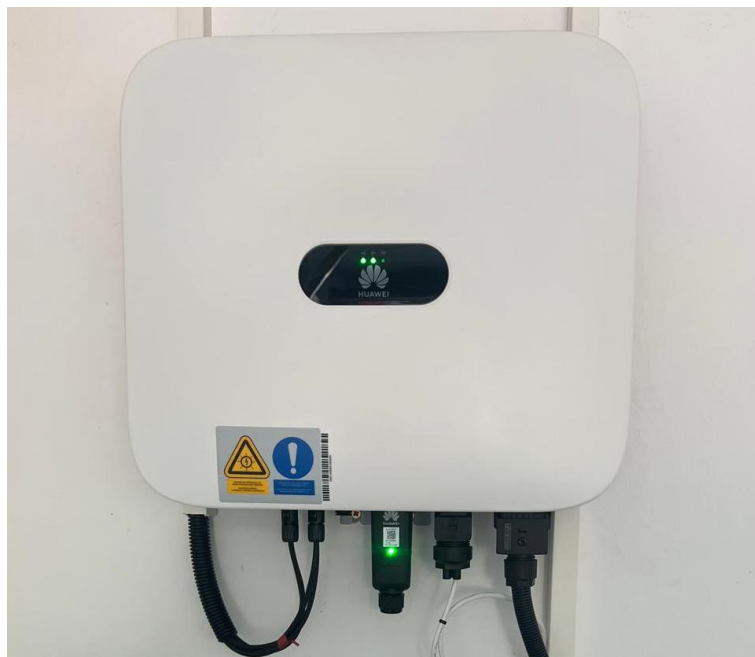
Slika 3.1. Huawei 10KTL centralni izmjenjivač
