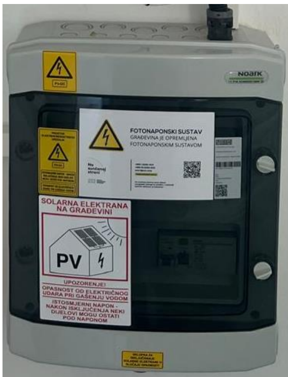
Slika 3.11. Pogled na priključni ormar – izvana
