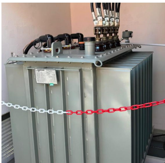
Slika 13. Trofazni uljni transformator
