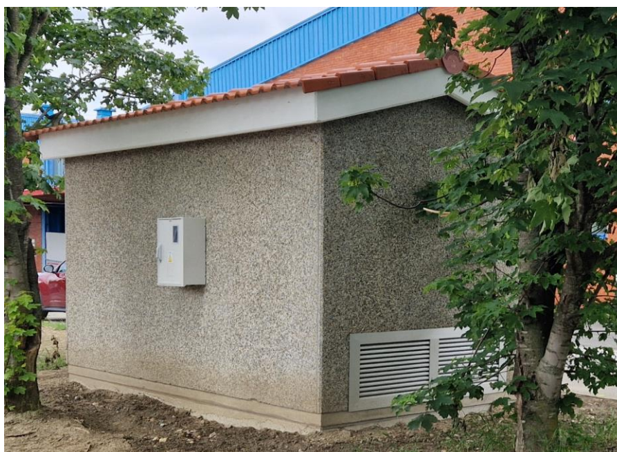
Slika 11. Vanjski izgled TS-a – iza
