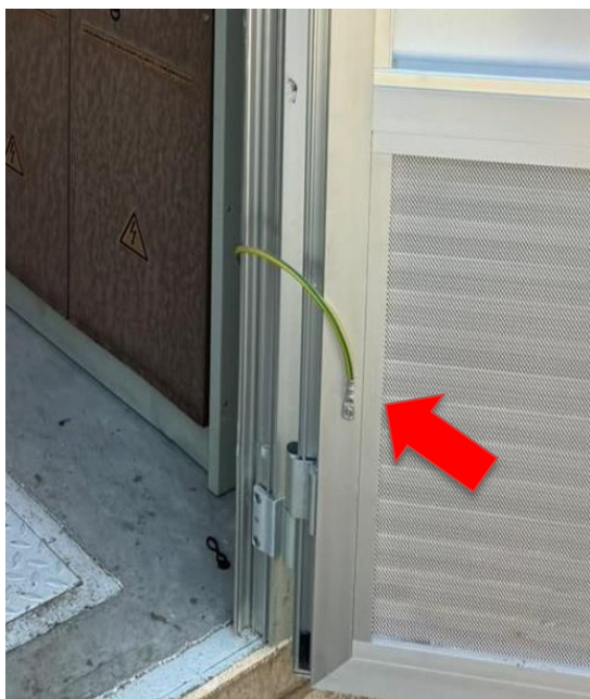
Slika 17. Zaštitno uzemljenje na vratima
