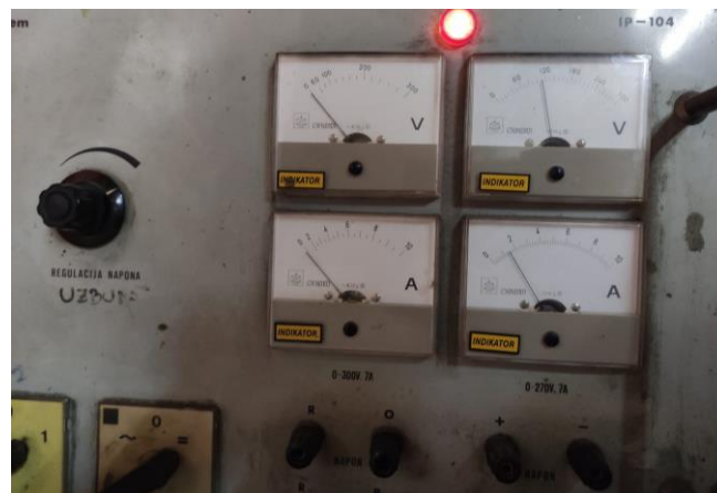
Slika 33. Napon i struja na ispitnoj stanici (slikano u Elki 28. 6. 2024.)
