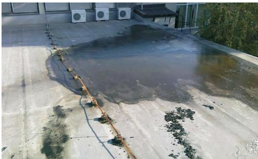
Slika 9.3.9. Nepravilna izvedba padova
