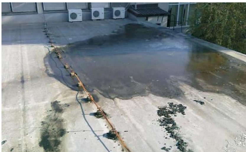
Slika 9.3.9. Nepravilna izvedba padova
