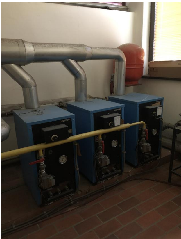
Slika 4. Postojeći sustav grijanja
