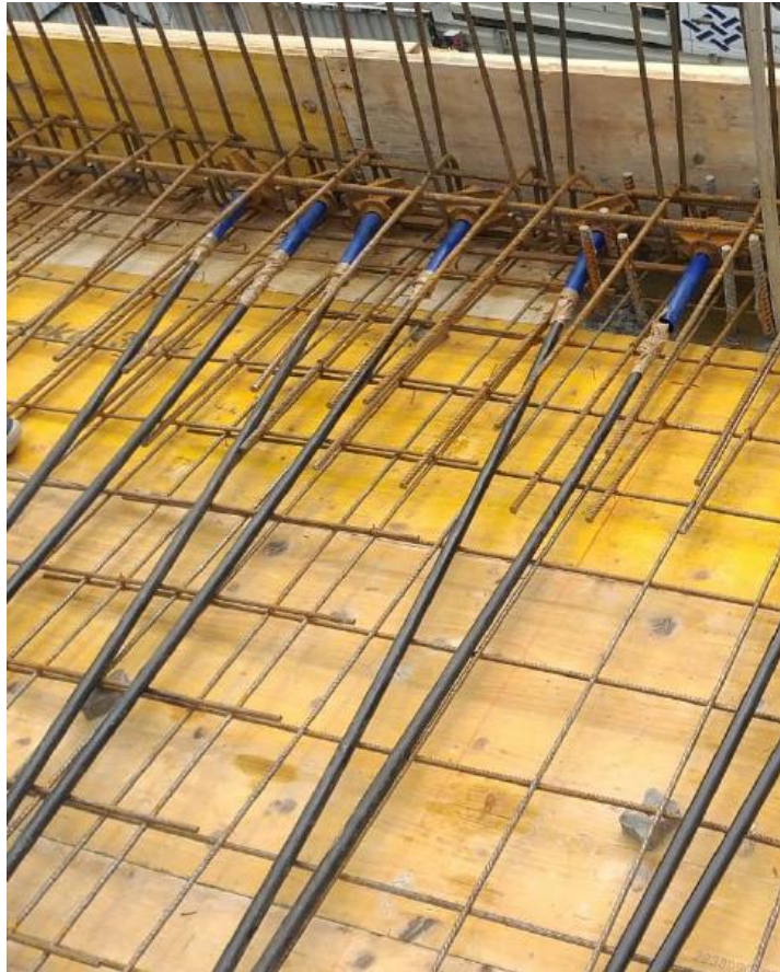
Slika 2.8 Pasivna usidrenja kabela – primjer na dogradnji hotela Punta na Malom Lošinju (Izvor: [8])
