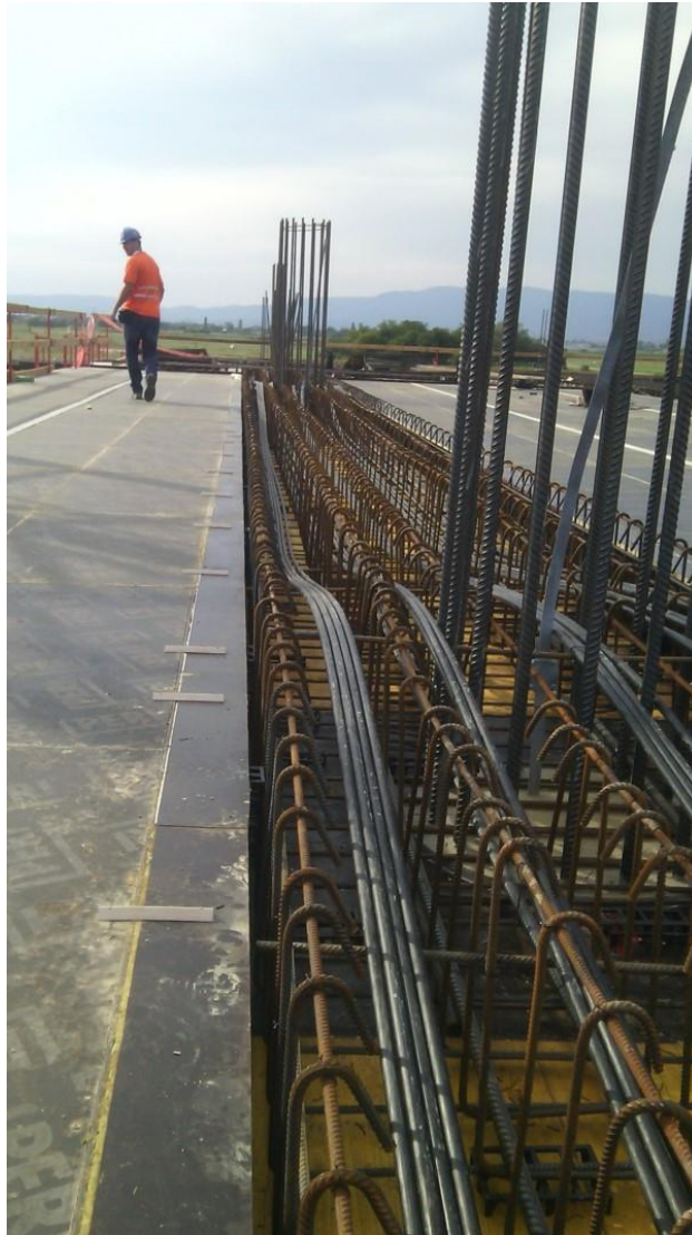
Slika 2.10 Polaganje kabela (slobodno vođenje) – plitka, široka greda (slika prije postavljanja gornje zone armature grede) (Izvor: [3])
