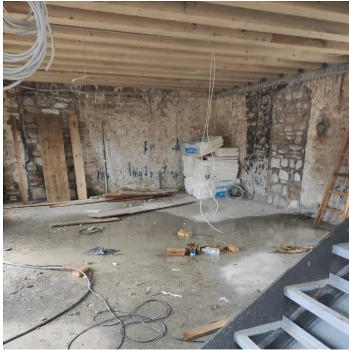
Slika 92. Zatvoreni stari otvori
