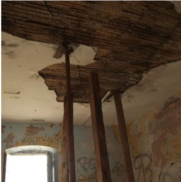
Slika 17. Oštećen strop i zid na prvom katu
