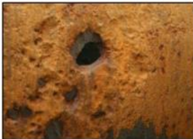
Slika 5.1.1.1 Primjer oštećenja nastalog zbog rupičaste korozije [30]
