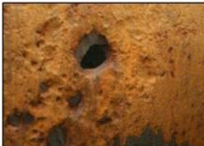
Slika 5.1.1.1 Primjer oštećenja nastalog zbog rupičaste korozije [30]
