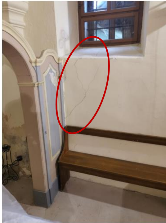
Slika 38: Pukotine ispod prozora na južnom pročelju
