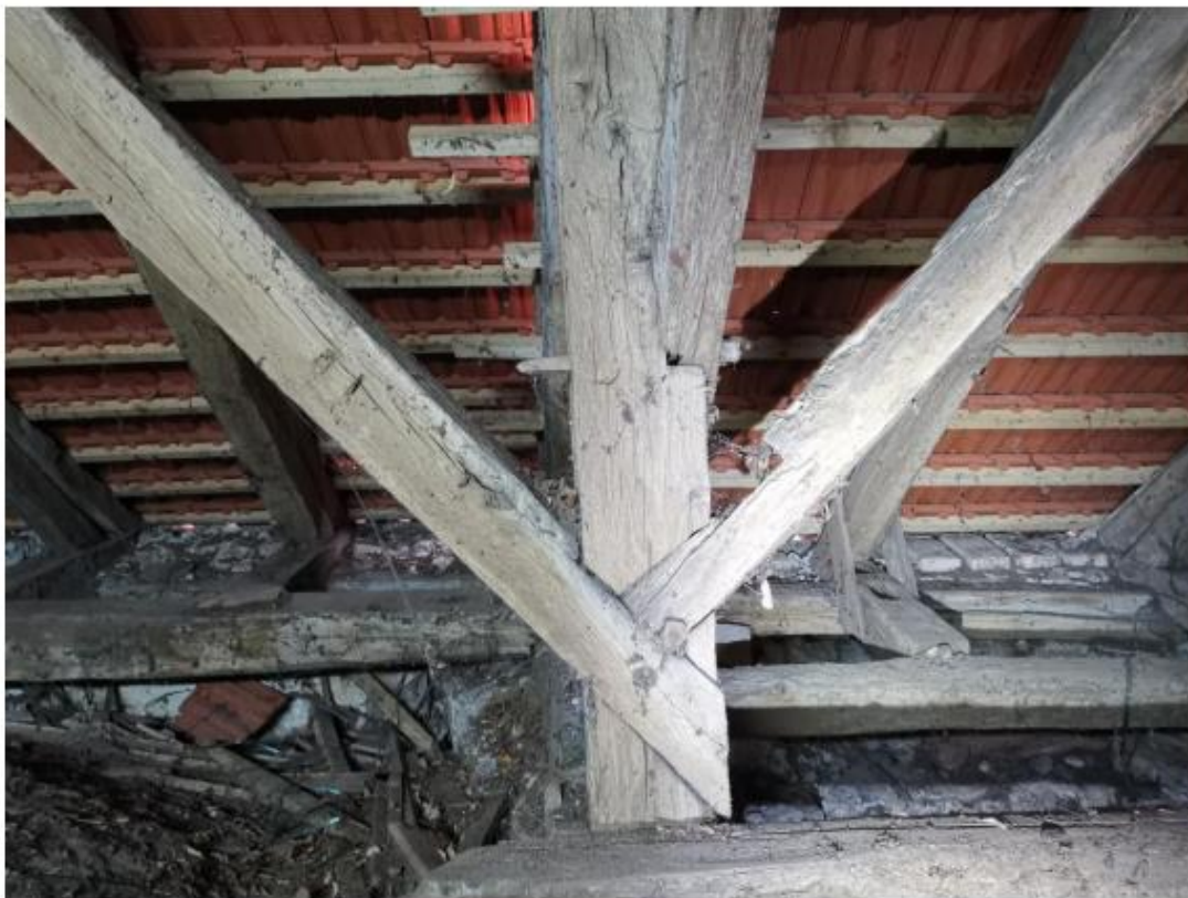
OSLABLJENI SPOJEVI DRVENE KROVNE KONSTRUKCIJE
