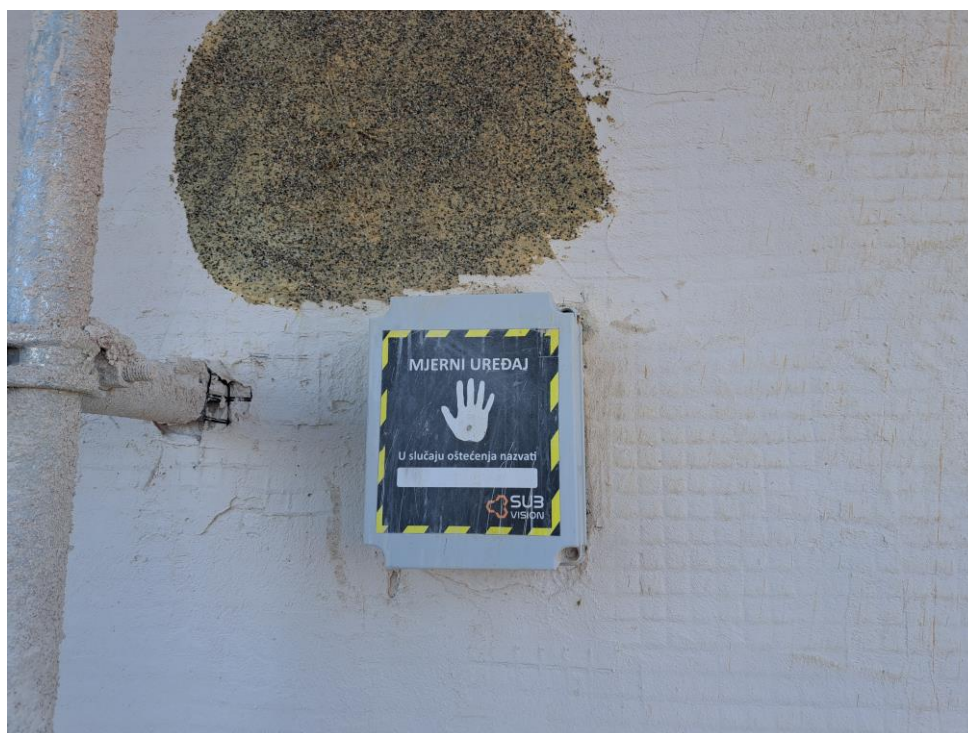
Slika 57: Ojačavanje MAPEWRAP FIOCCO zidova kapele (gore) i mjerni uređaj za praćenje pomaka zidova nakon mjere sanacije (dolje)
