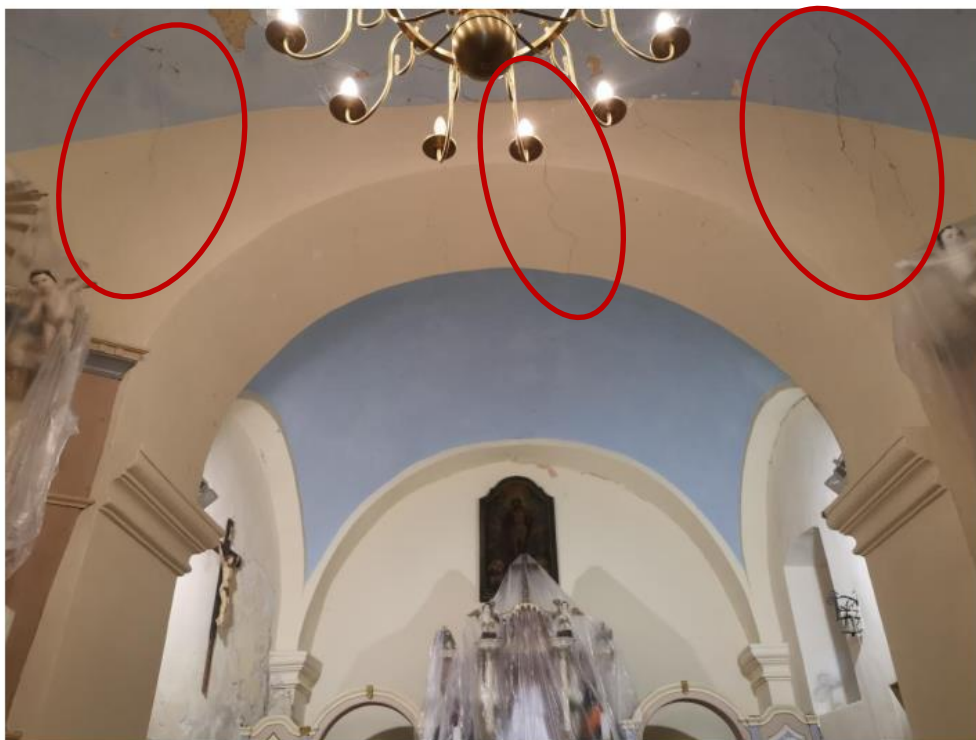
Slika 37: Pukotine na središnjem luku
