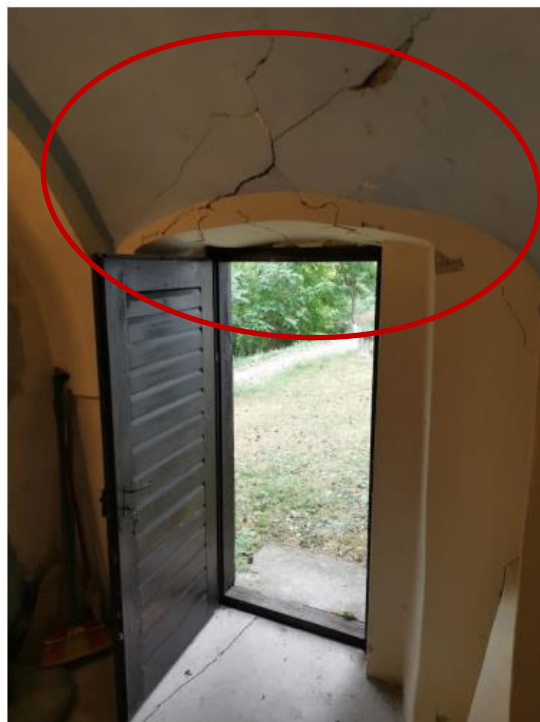
Slika 39: Pukotine na svodu ulaznog prostora (Izvor: vlastita fotografija autora)
