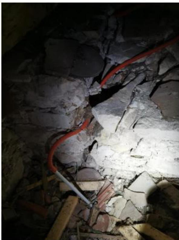
POJAVA PUKOTINE OD 5cm U ZIDU – puknuće glavnog luka svetišta
