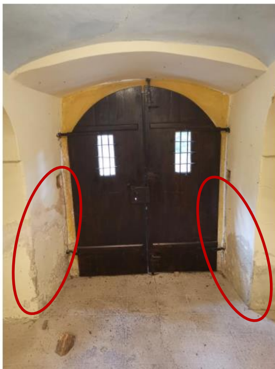
Slika 33: Oštećenja zida ulaznog prostora
