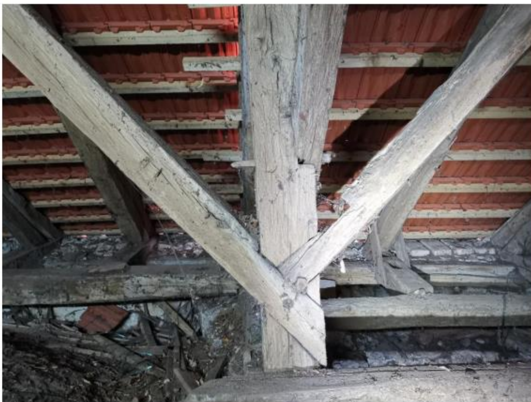
OSLABLJENI SPOJEVI DRVENE KROVNE KONSTRUKCIJE
