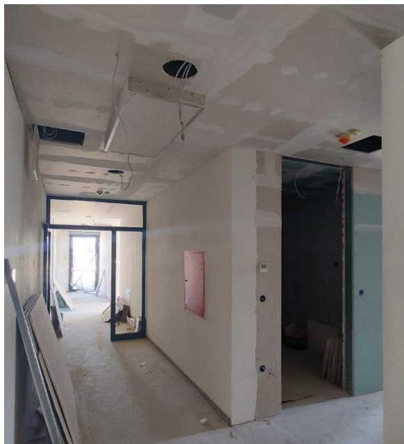
Slika 21. Prikaz denivelacije stropa u hodniku zbog instalacija
