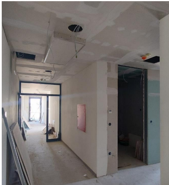
Slika 21. Prikaz denivelacije stropa u hodniku zbog instalacija
