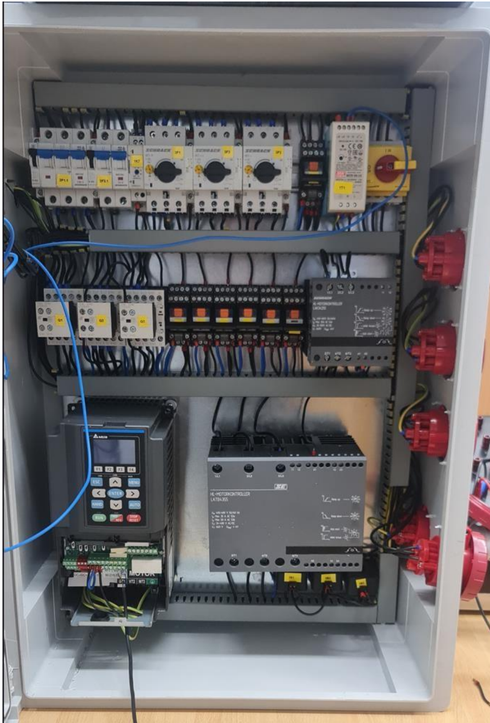
Slika 4.3 – Izgled gotovog elektro ormara
