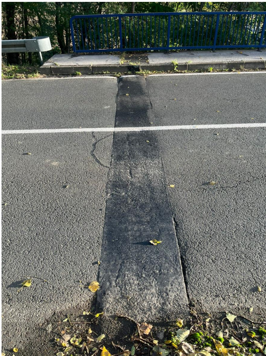
Slika 32 Bitumenska kontinuirana prijelazna naprava na nadvožnjaku u Maloj Subotici, (10.10.2024.)
