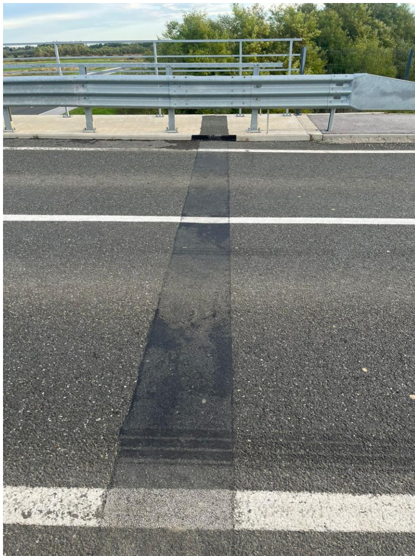
Slika 34 Bitumenska kontinuirana prijelazna naprava na nadvožnjaku u Palovcu, (10.10.2024.)
