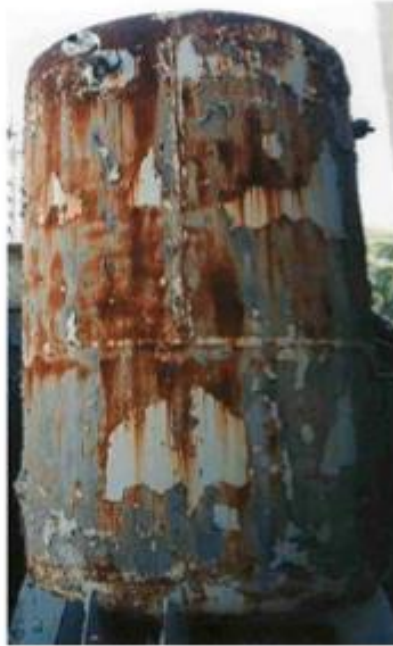
Slika 21. Primjer opće korozije spremnika [19]
