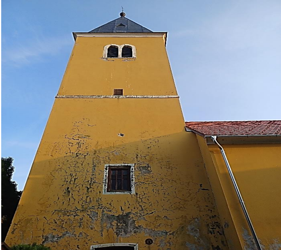
Slika 15. Prikaz oštećenja južnog pročelja
