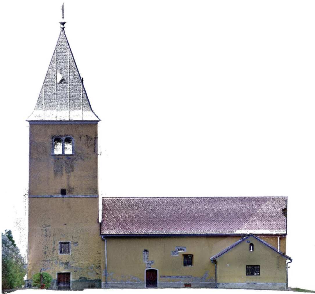
Slika 12. Južno pročelje- prikaz oštećenja pročelja
