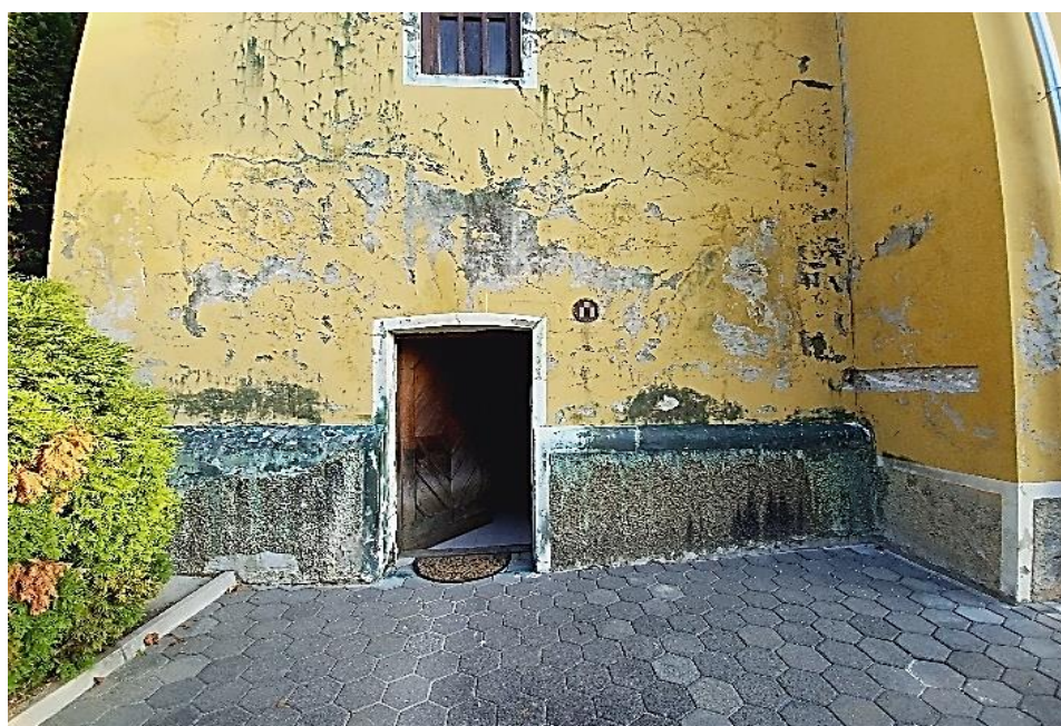
Slika 14. Prikaz oštećenja južnog pročelja
