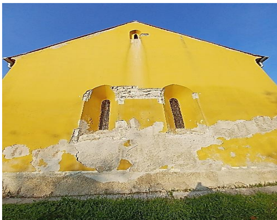
Slika 26. Prikaz oštećenja istočnog pročelja
