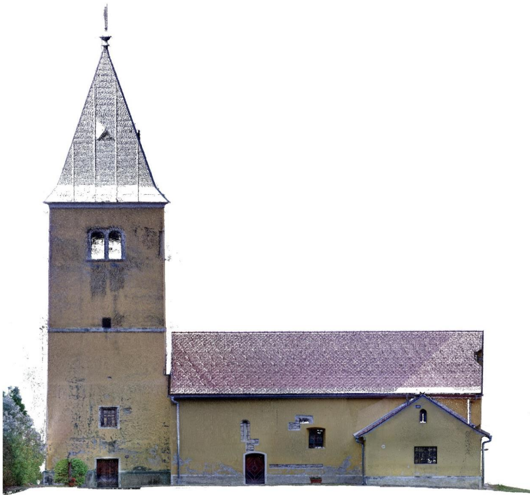
Slika 12. Južno pročelje- prikaz oštećenja pročelja
