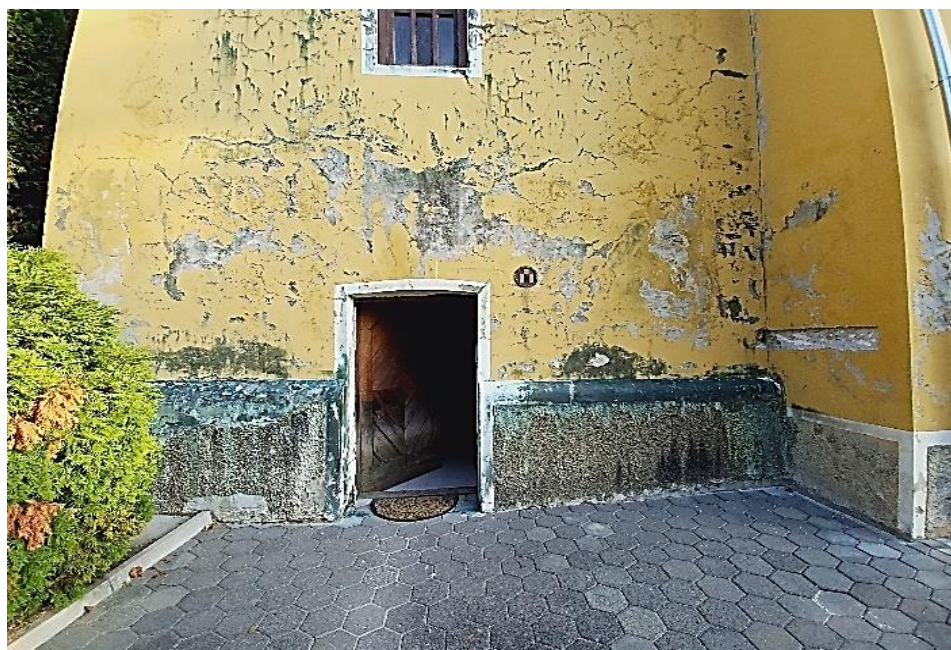
Slika 14. Prikaz oštećenja južnog pročelja
