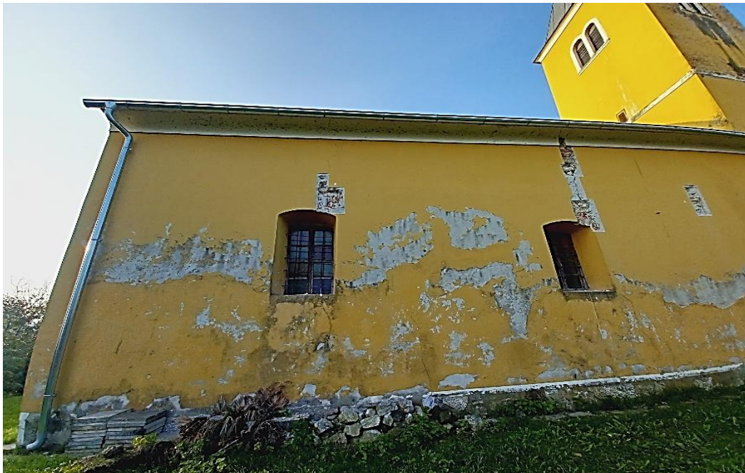
Slika 22. Prikaz oštećenja sjevernog pročelja
