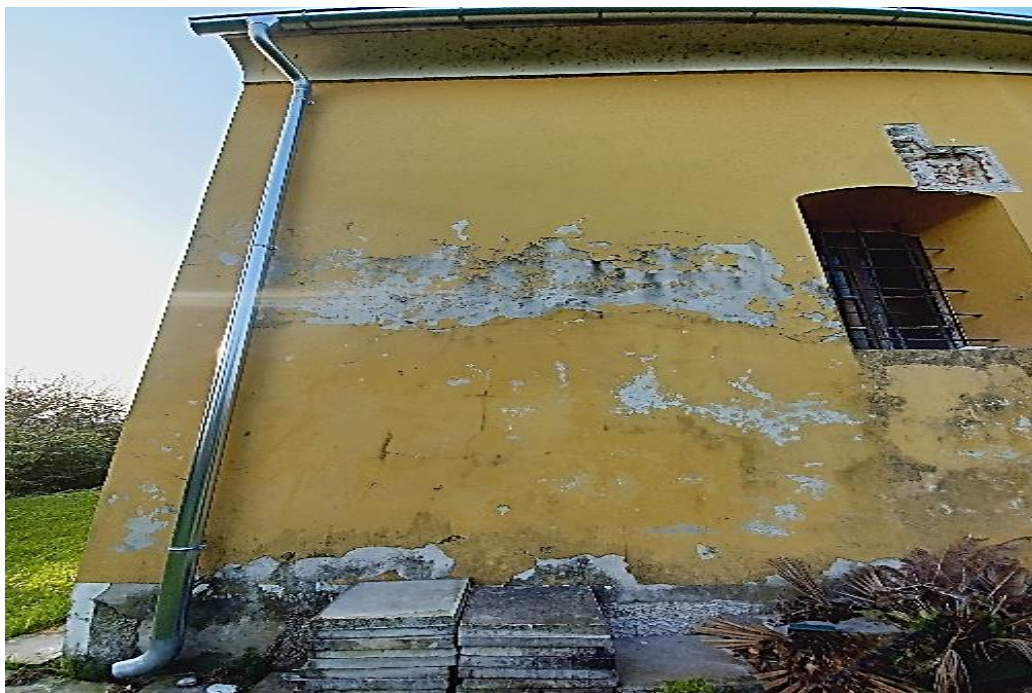
Slika 23. Prikaz oštećenja sjevernog pročelja
