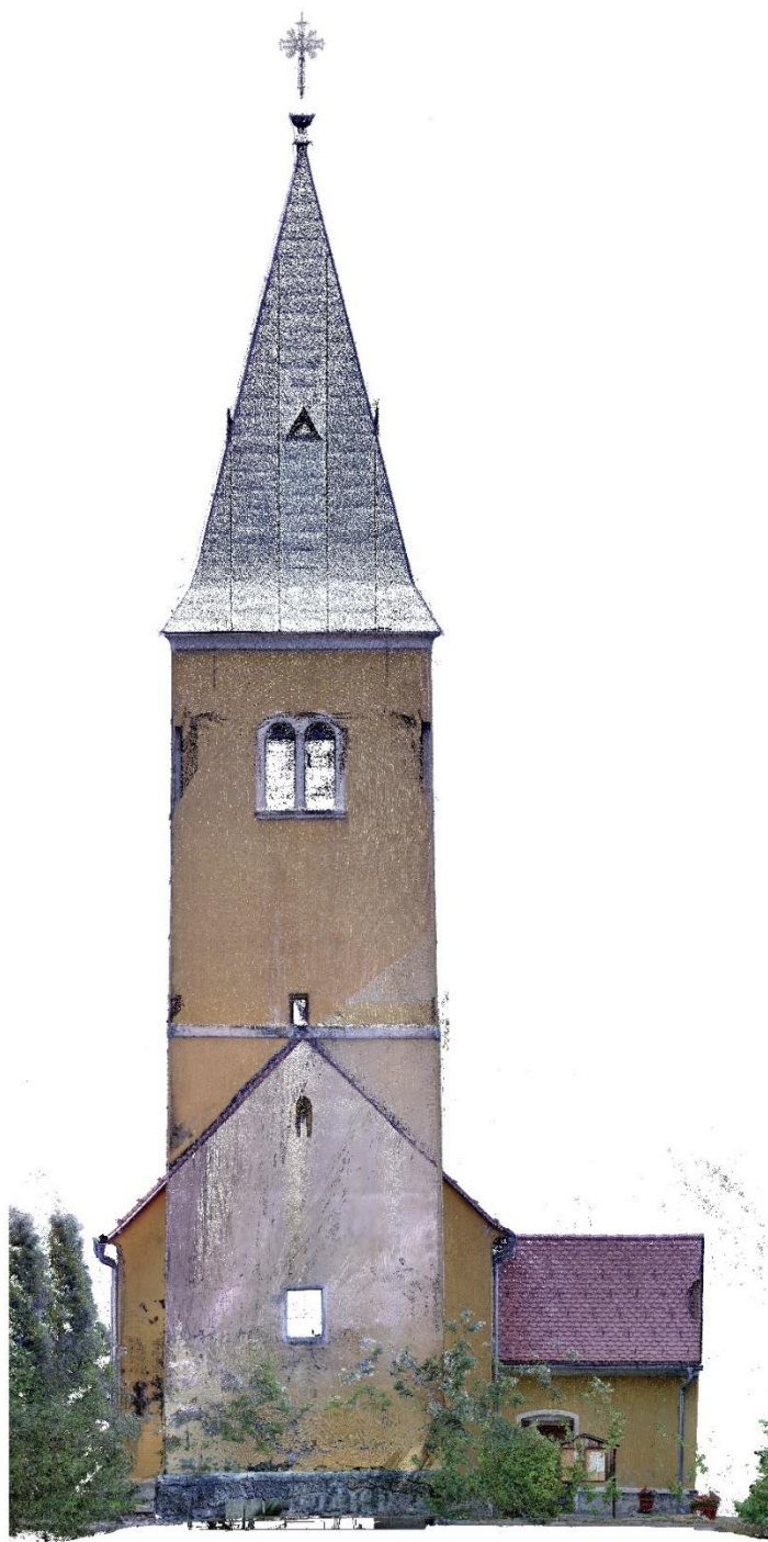
Slika 17. Zapadno pročelje- prikaz oštećenja pročelja
