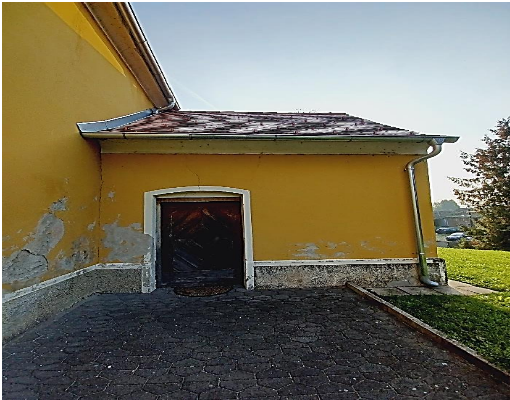
Slika 20. Prikaz oštećenja zapadnog pročelja
