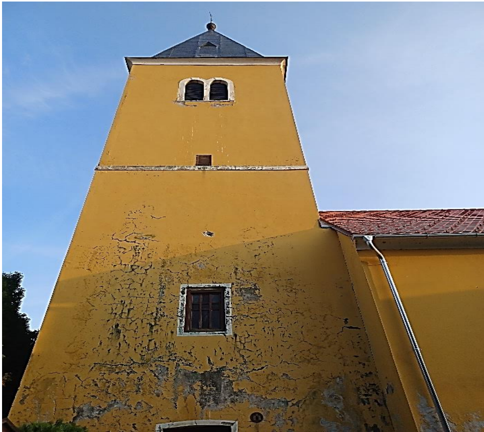
Slika 15. Prikaz oštećenja južnog pročelja
