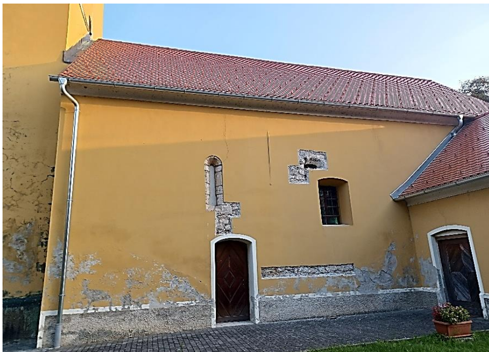
Slika 16. Prikaz oštećenja južnog pročelja
