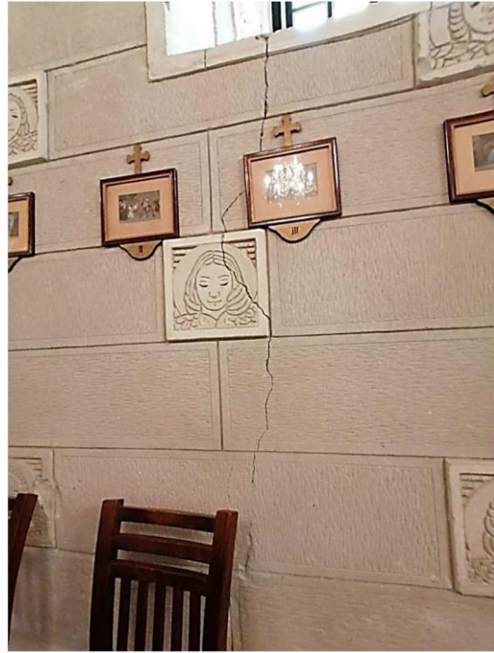
Slika 40. Oštećenje desnog zida broda crkve
