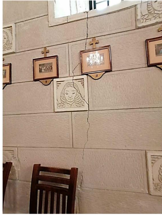
Slika 40. Oštećenje desnog zida broda crkve
