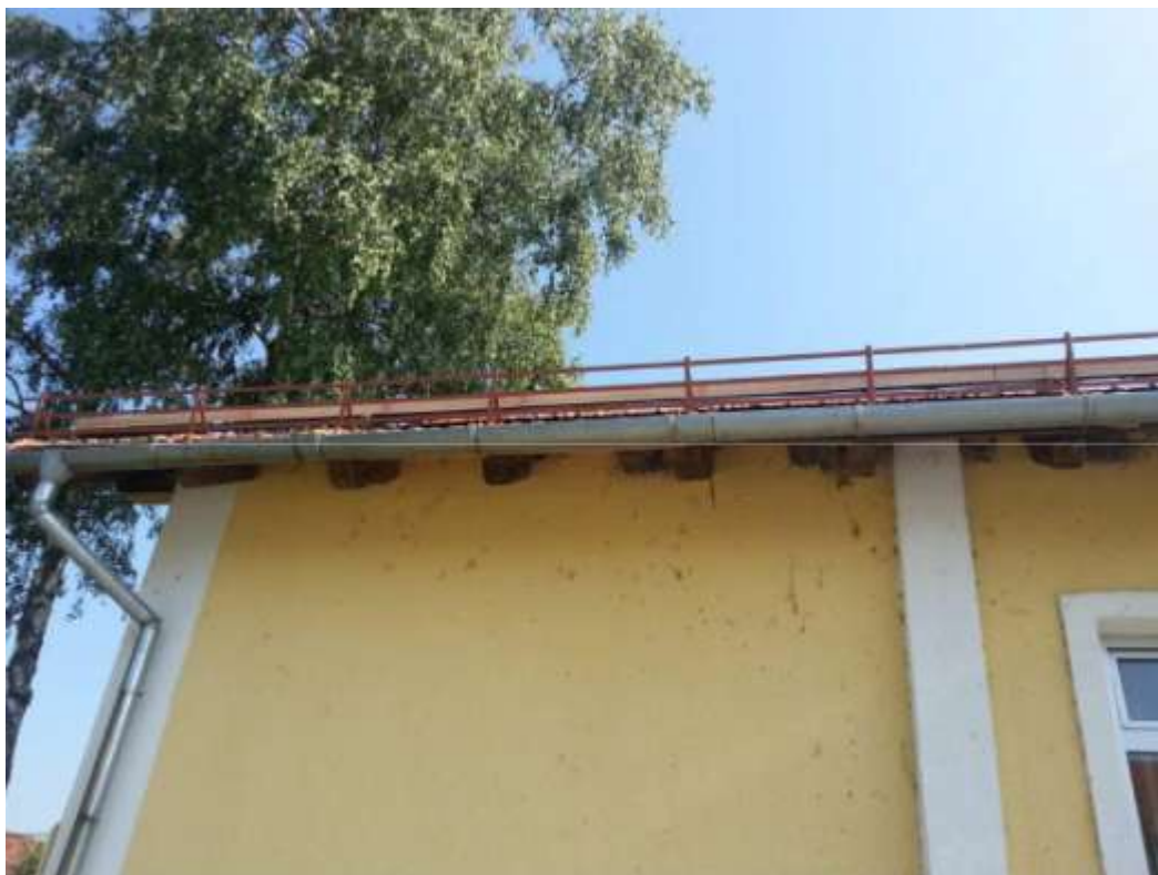
SLIKA 4.3. Postavljen snjegobran na predmetnoj solarnoj elektrani
