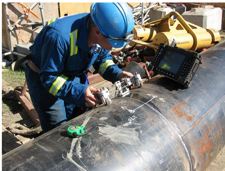
Slika 5.1 Ultrazvučna kontrola plinovoda [30]
