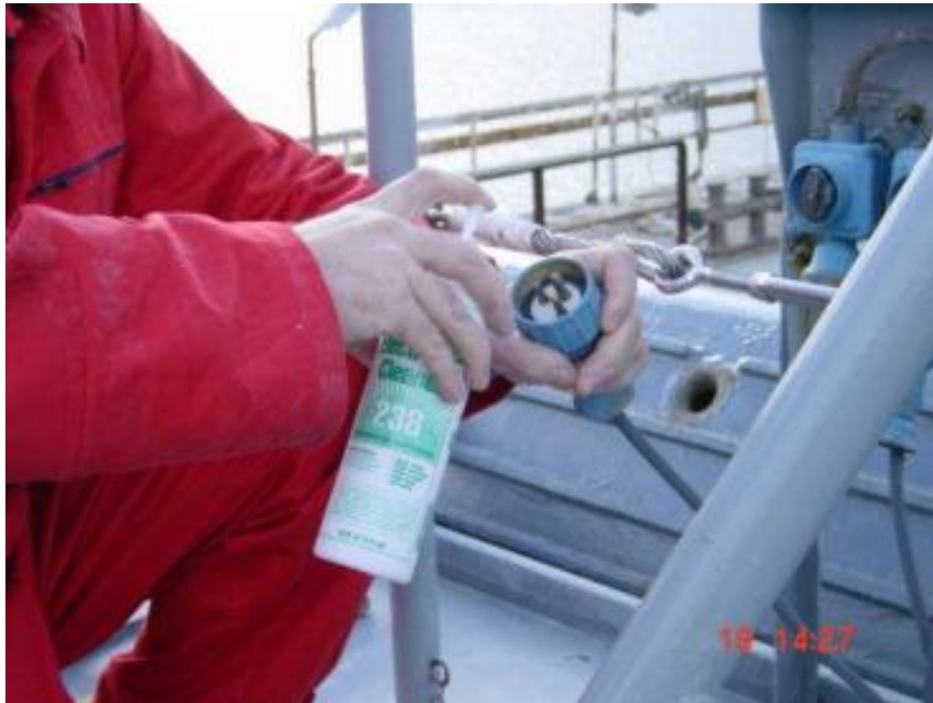
Slika 5.26 Primjena inhibitora za zaštitu električnih kontakata [55]
