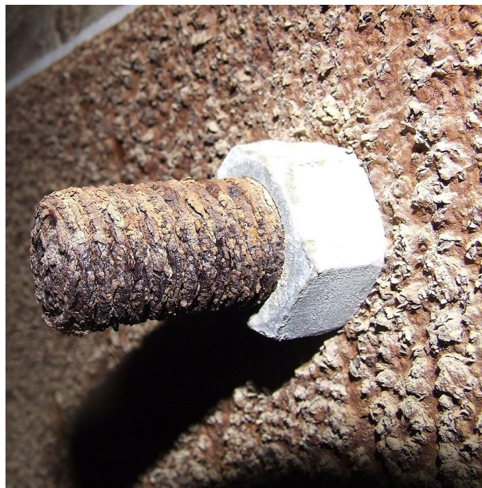
Slika 4.7 Primjer elektrokemijske korozije metala [16]
