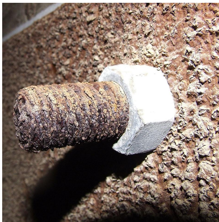
Slika 4.7 Primjer elektrokemijske korozije metala [16]
