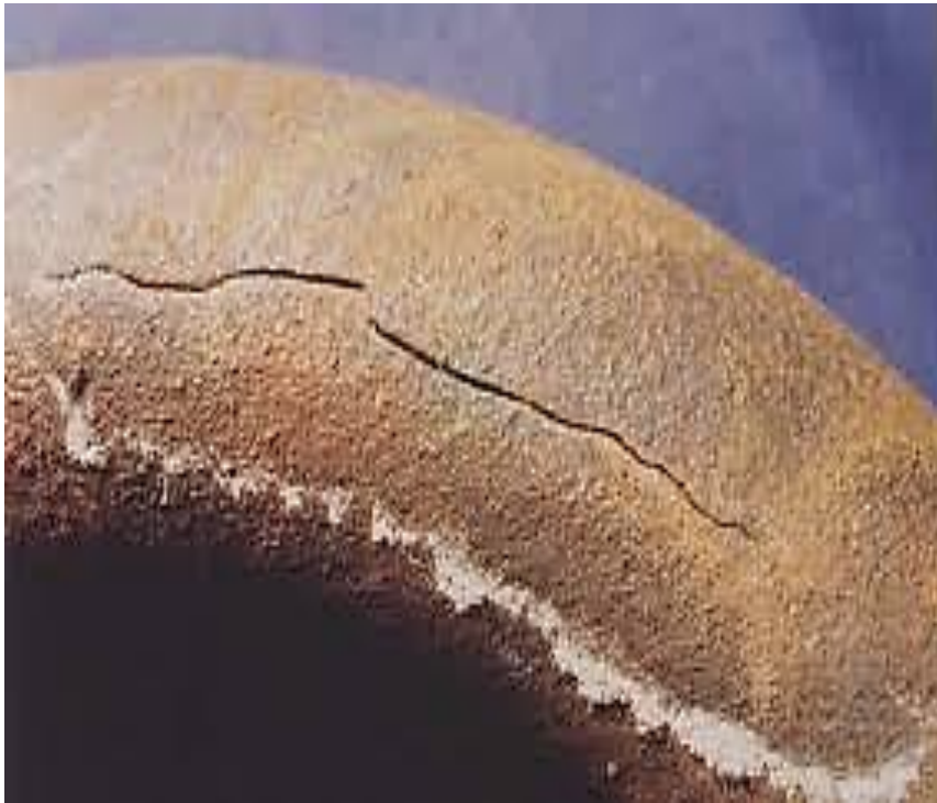
Slika 4.20 Primjer napetosne korozije ugljičnog čelika [34]
