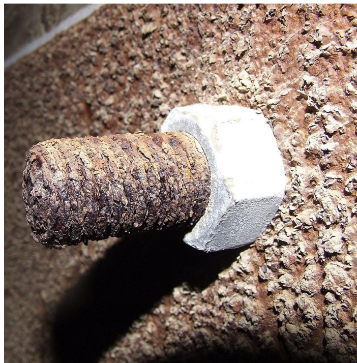
Slika 4.7 Primjer elektrokemijske korozije metala [16]
