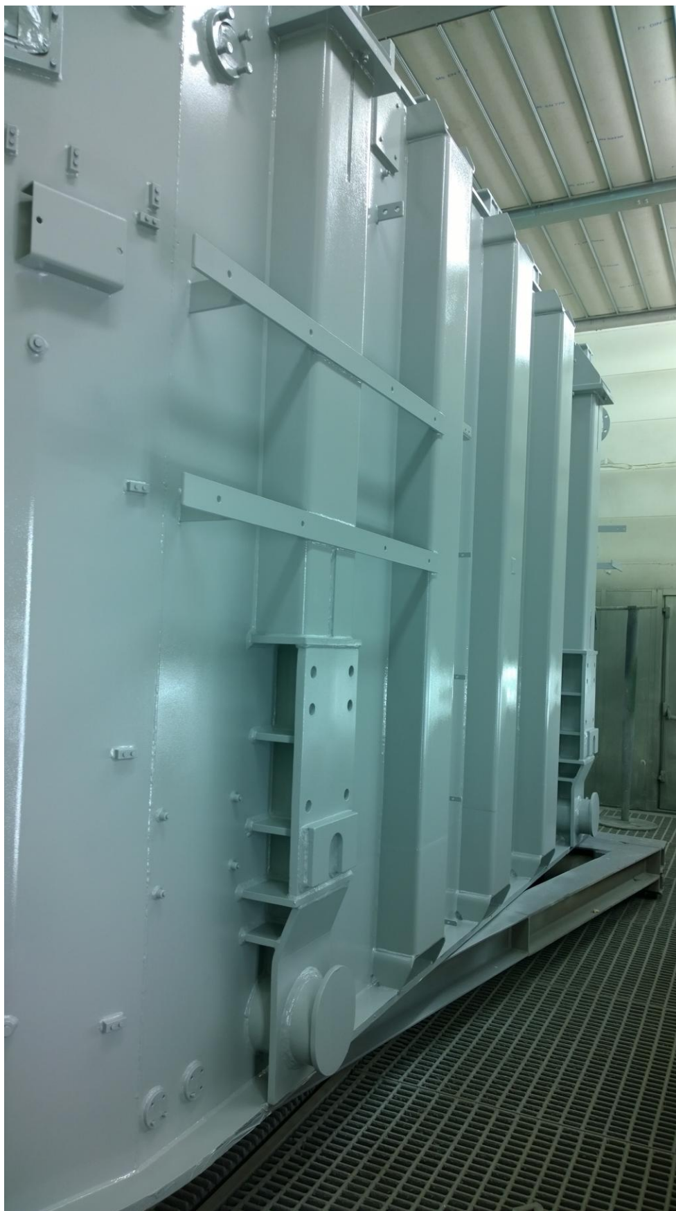
Slika 6.23 Izgled gotovog kotla
