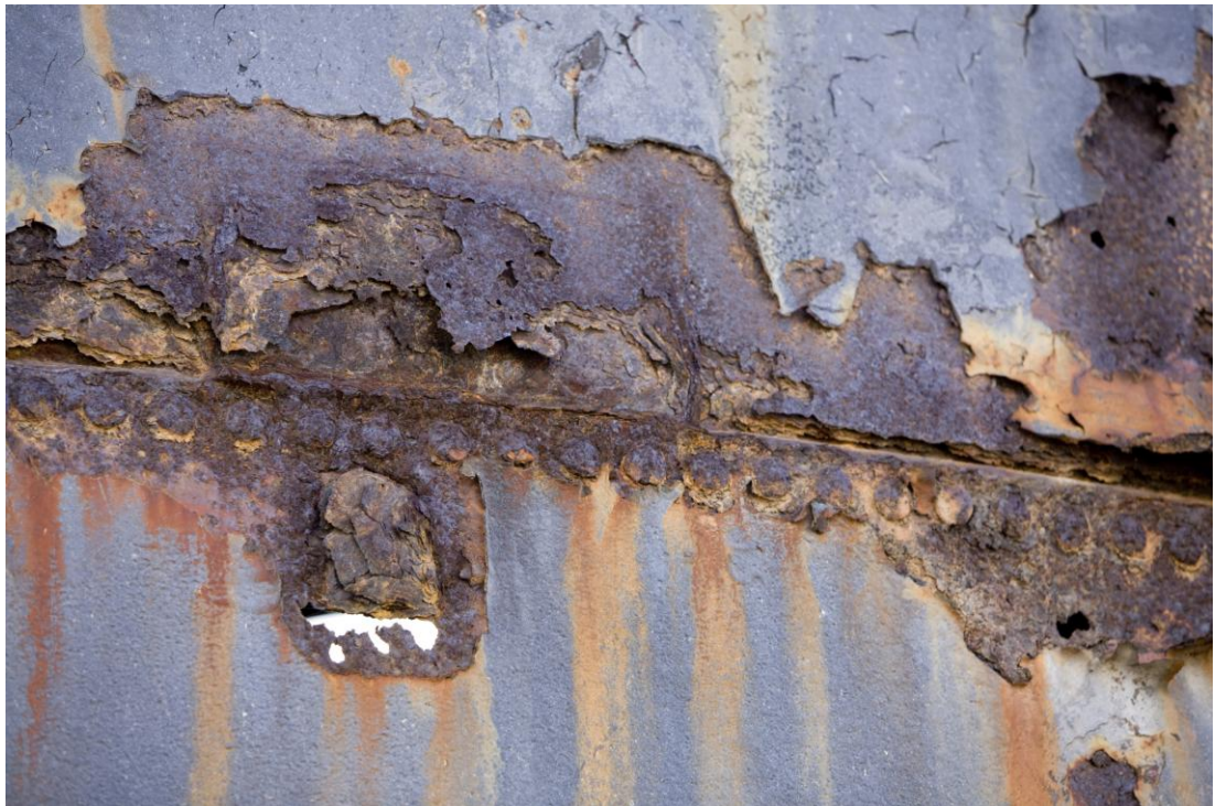
Slika 4.14 Primjer potpovršinske korozije- listanje [25]
