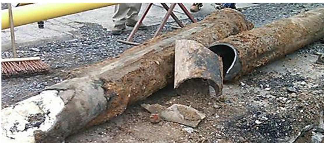
Slika 4.18 Tamne mrlje na vanjskoj strani cijevi predstavljaju oblik korozije specifične za lijevano željezo poznato kao grafitizacija sivog lijeva [32]
