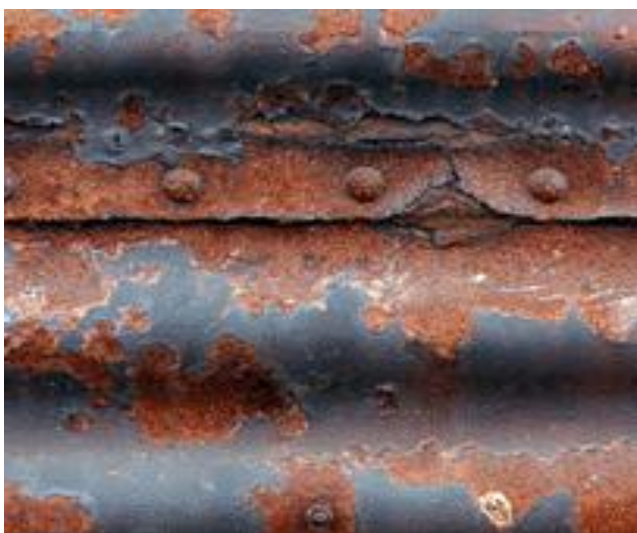
Slika 4.4 Primjer kemijske korozije vanjske ograde [13]
