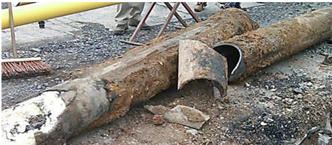
Slika 4.18 Tamne mrlje na vanjskoj strani cijevi predstavljaju oblik korozije specifične za lijevano željezo poznato kao grafitizacija sivog lijeva [32]
