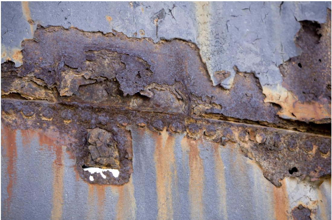
Slika 4.14 Primjer potpovršinske korozije- listanje [25]
