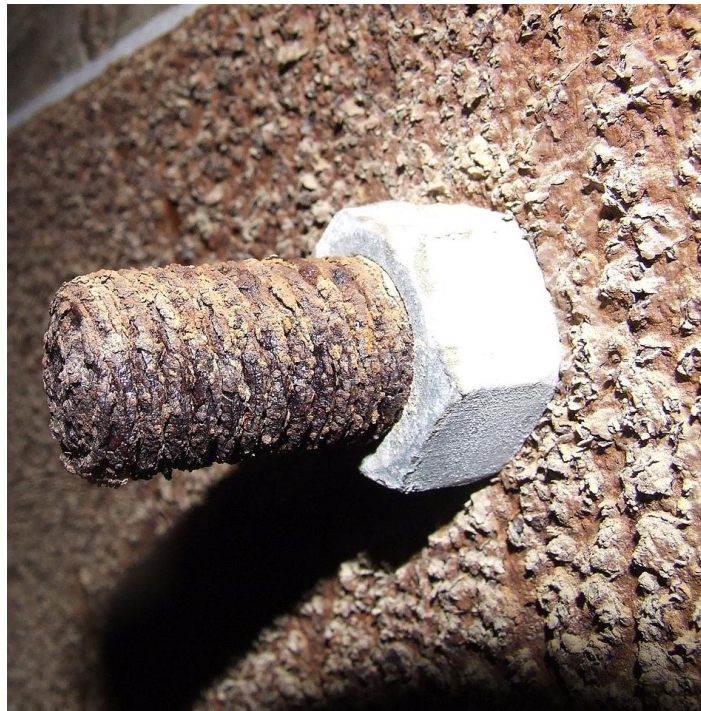
Slika 4.7 Primjer elektrokemijske korozije metala [16]
