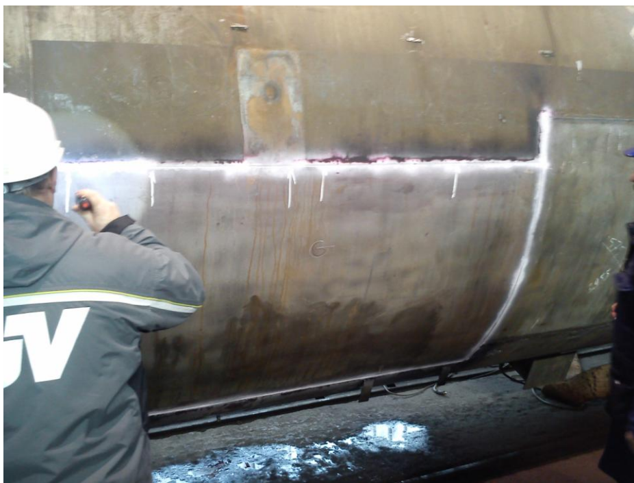
Slika 32. Pregled zavarenih spojeva nakon ispitivanja
