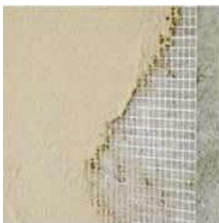
Slika 3.4.4. Sloj ljepila u debljini 3,00 mm u koji se utapa tekstilno-staklena alkalno otporna mrežica, nakon toga nanosi se još jedan sloj ljepila za izravnavanje
