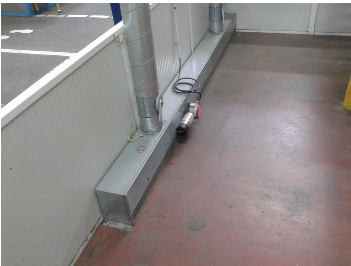
Slika 11. Osjetnik broj 1 za propan, i ventilacija
