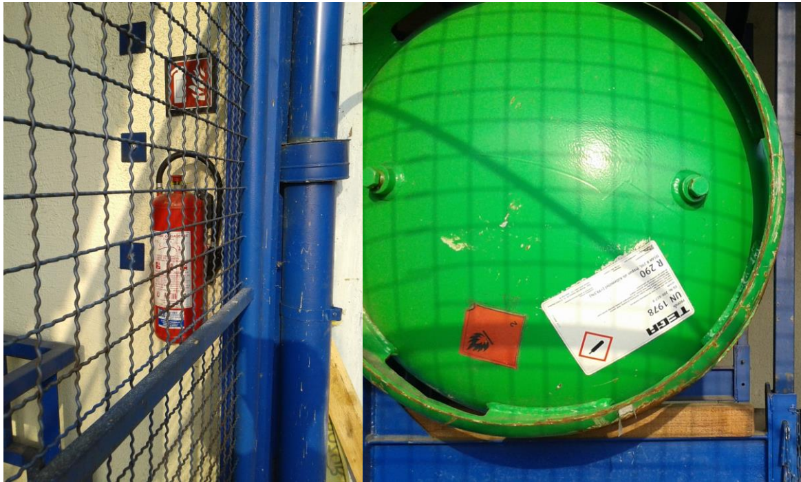
Slika 19. Aparat za gašenje požara i spremnik propana
