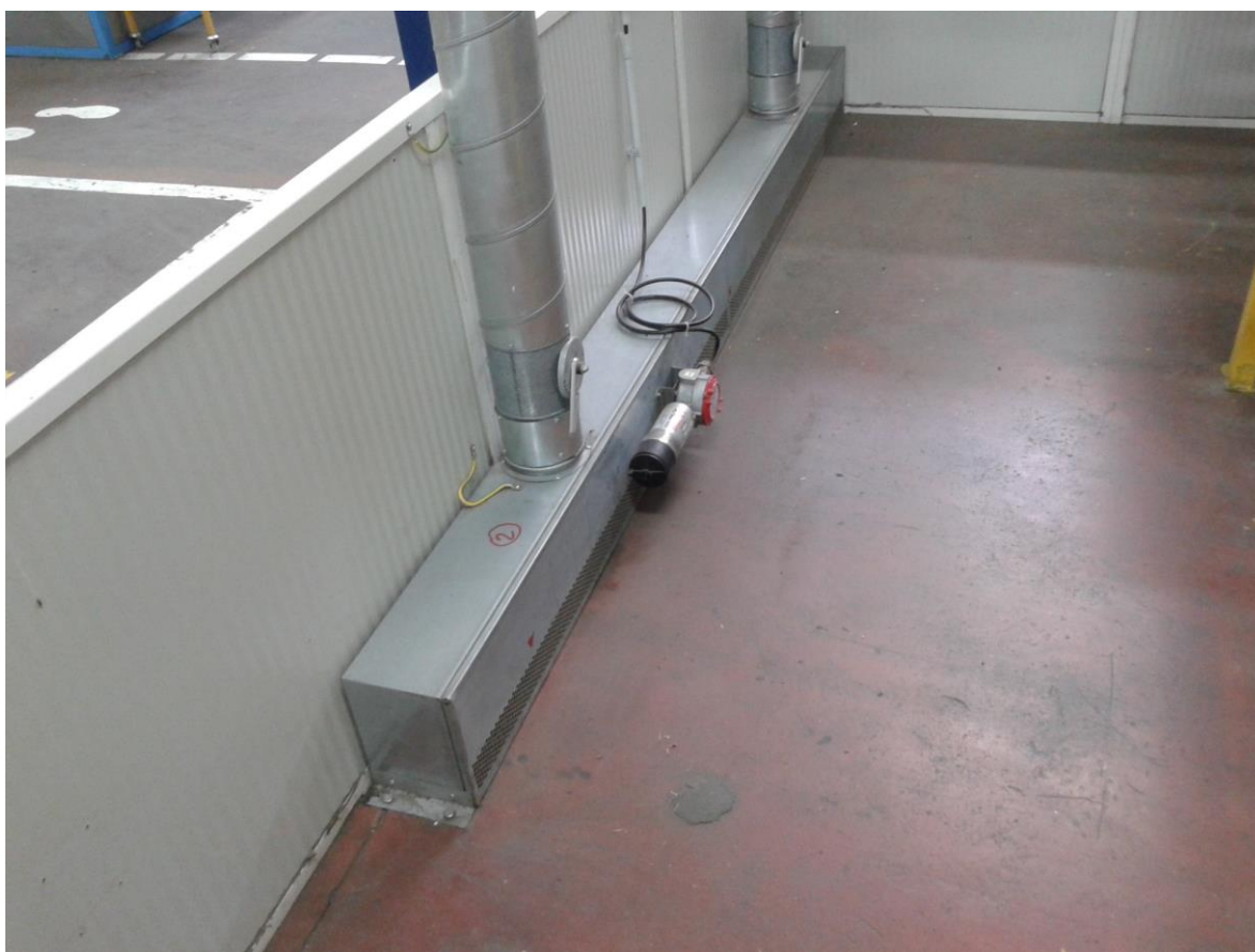
Slika 11. Osjetnik broj 1 za propan, i ventilacija
