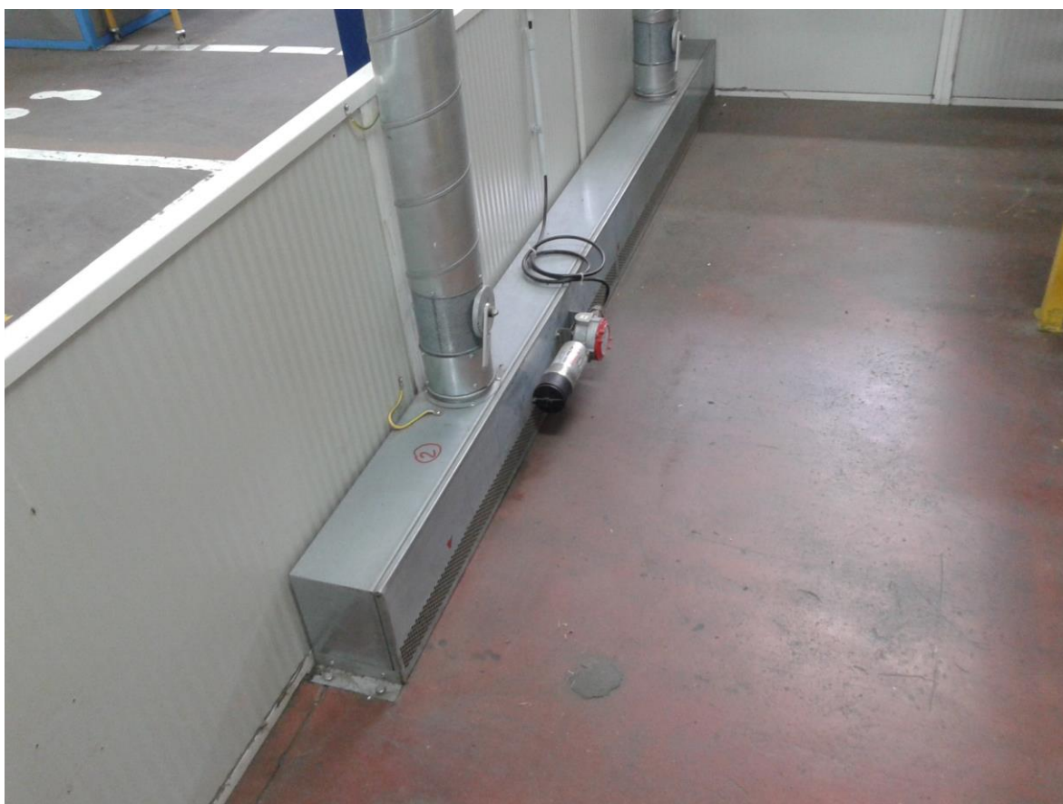
Slika 11. Osjetnik broj 1 za propan, i ventilacija
