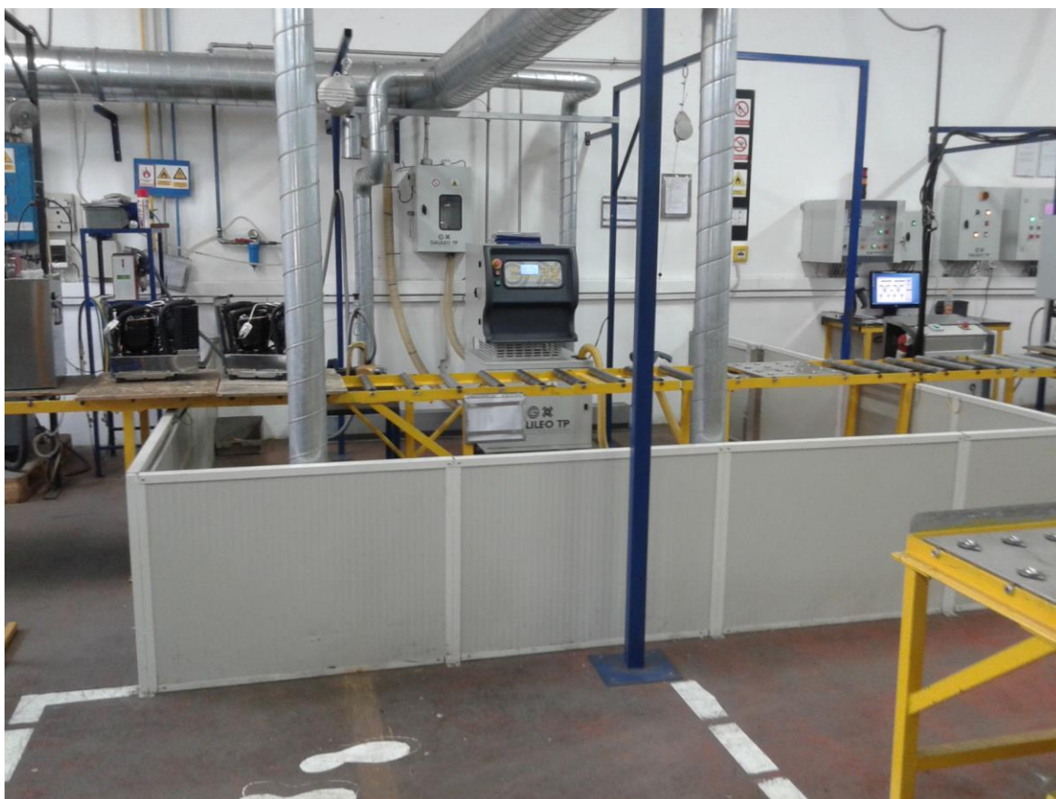
Slika 10. Ograđeni prostor za punjenje propanom, i pripadajuća ventilacija
