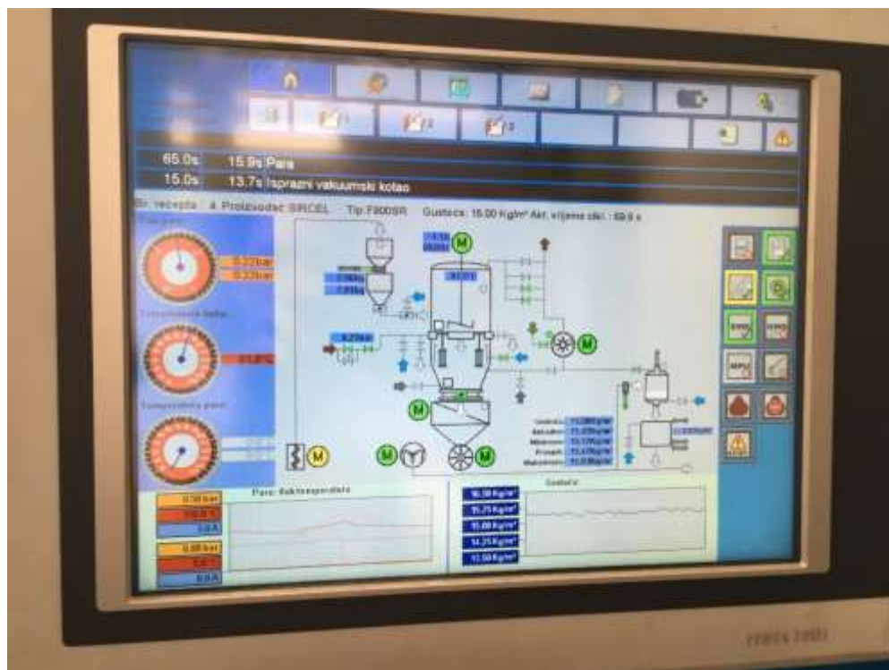
Slika 4.6 Modul za upravljanje predekspanderom
