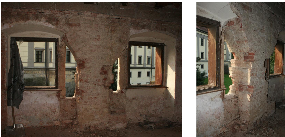
Slika 3.3. Oštećenje lukova na I.katu
