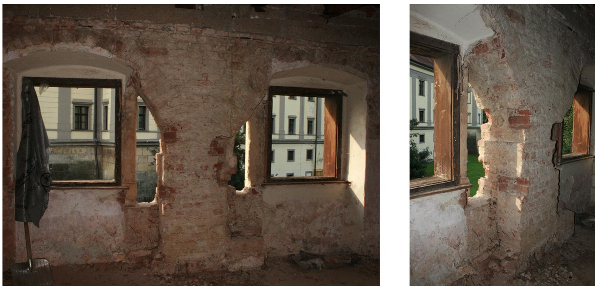
Slika 3.3. Oštećenje lukova na I.katu
