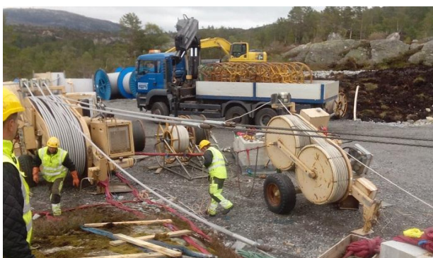
Slika 4.6. Impulzivne početne spojnice za razvlačenje vodiča
