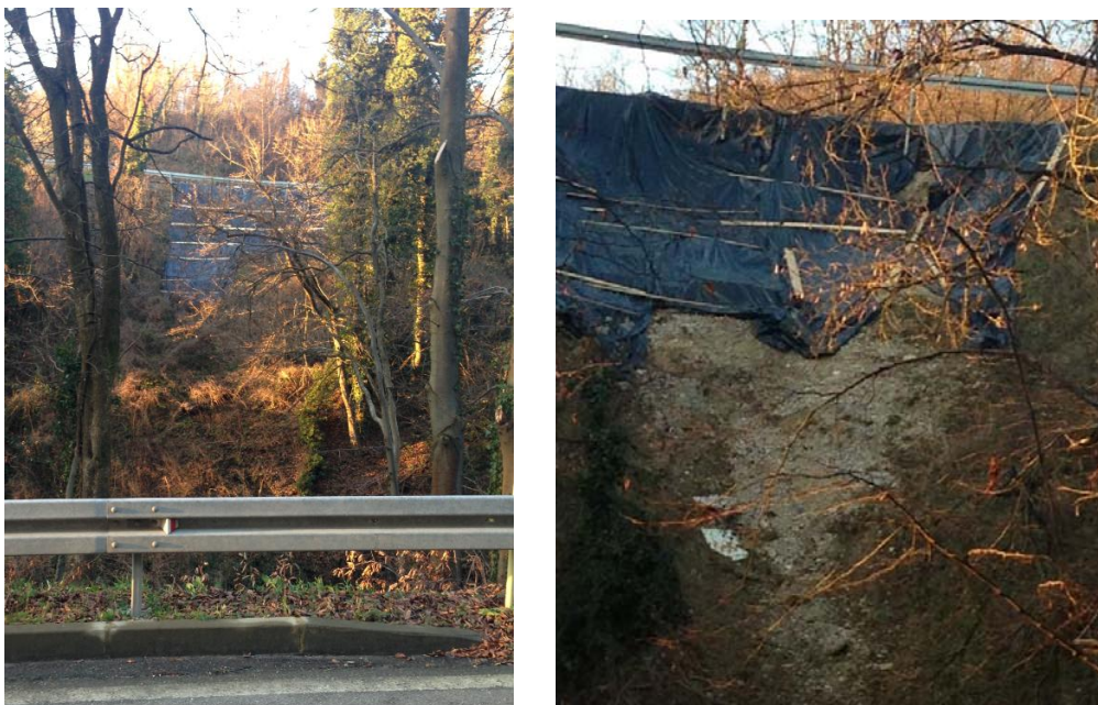
Slika 8.4: Klizišta: Kipišće I. i Kipišće II. na razmaku cca 30 m
