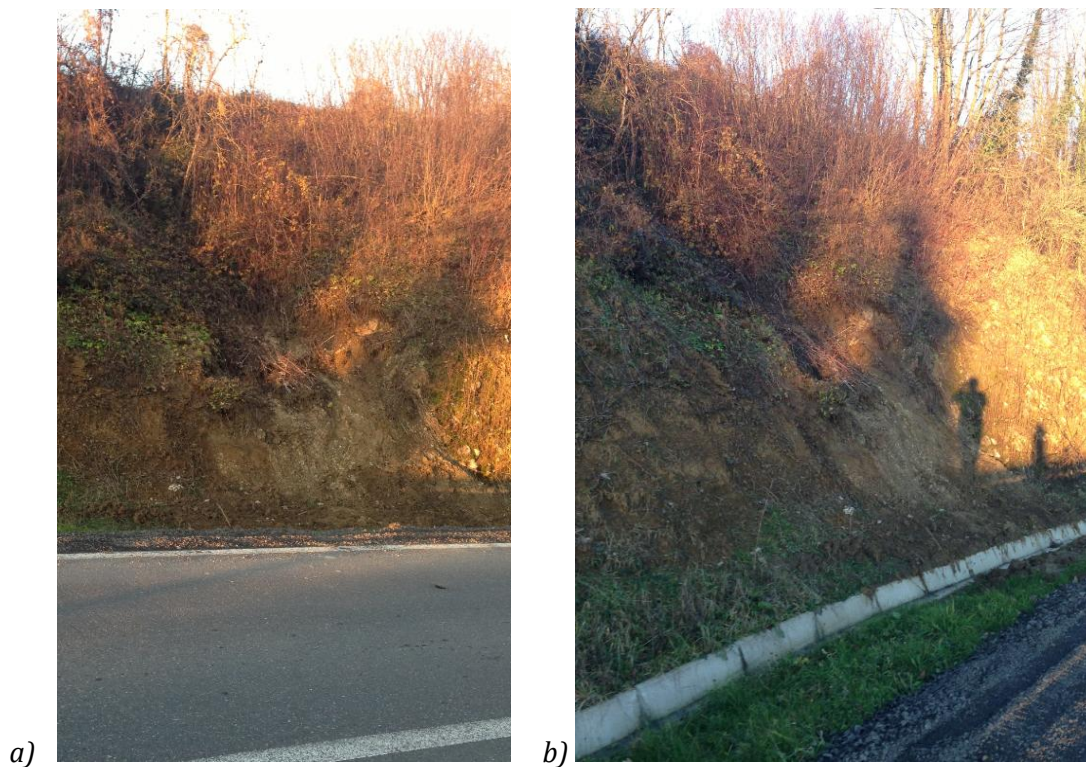
Slika 8.7: U zasjeku su vidljive manje površinske erozije – vododerine
