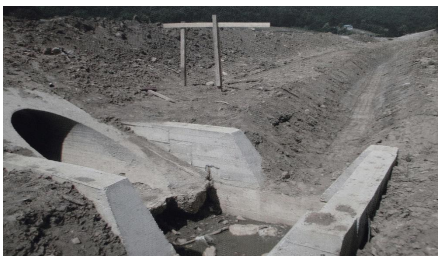
Slika 5.45: Uljevna glava propusta
