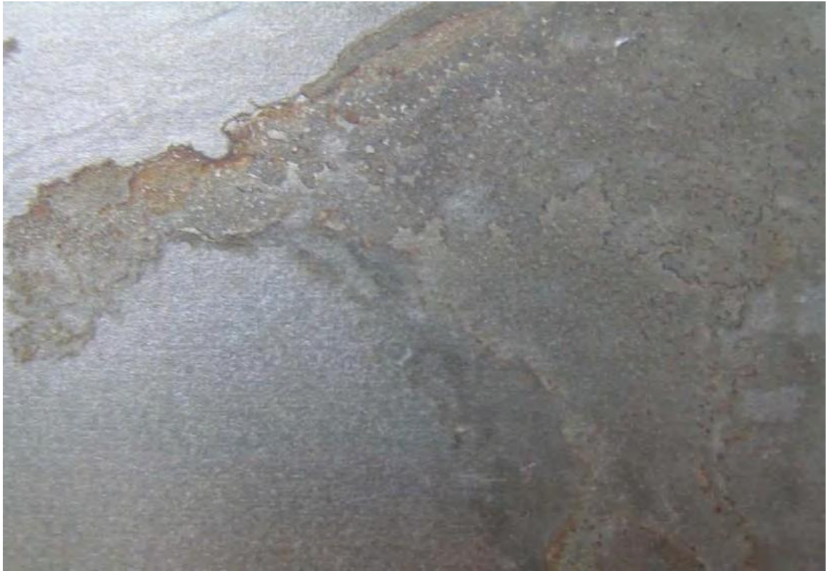
Slika 33 - Početna neobrađena korozija čeličnog lima
