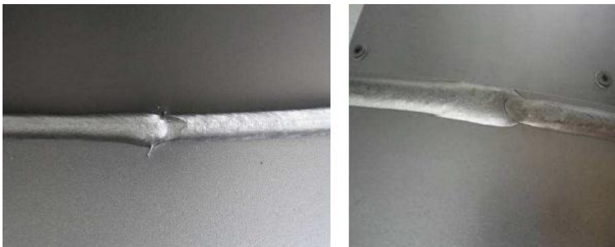
Slika 2.24 Nepravilno izveden nastavak zavora (517) [13]
